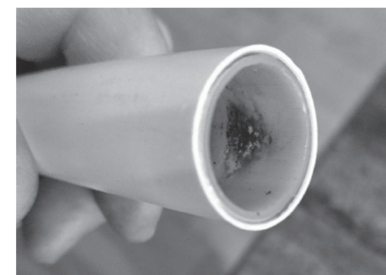
写真6 絶縁用の誘電体部が焦げている
